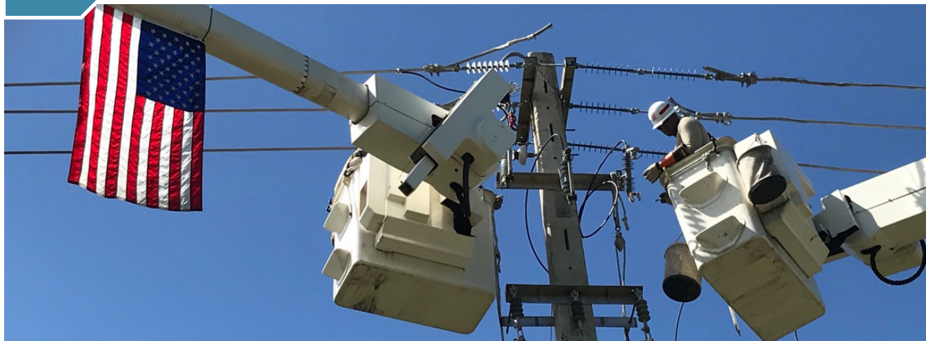
Operarios de mantenimiento de líneas trabajan para restaurar la energía eléctrica en Puerto Rico tras el paso del huracán María en 2017.
